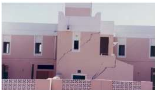
شکل ۲. ساختمان آسیب دیده در اثر تورم خاک زیر بنا [۶] Fig. 2. A damaged building due to swelling [5]
