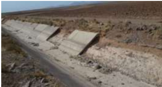
شکل 5. مناطقی از کانال اصلی دشت قزوین فاقد پوشش. Fig. 5. Some Area of the main canal in Qazvin Plain without Concrete Cover
